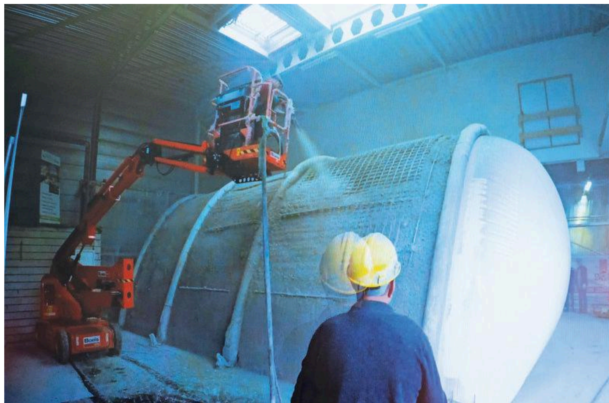
„We blazen een grote plastic ballon op, spuiten er beton overheen, laten de ballon weer leeglopen en de constructie staat”, vertelt Bas.
